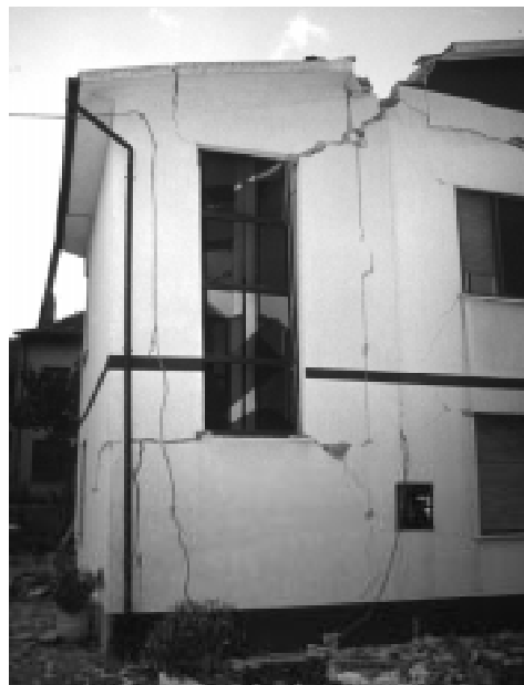
Bild 6: Einfamilienhaus mit groben Rissen um grosse Fensteröffnung
