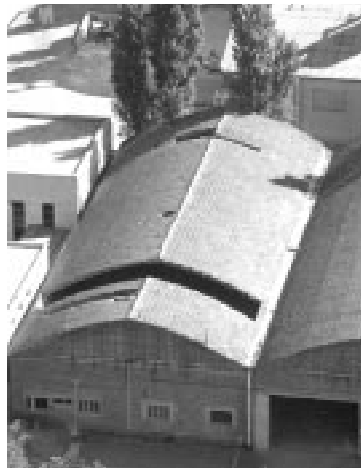
Bild 8: Ältere Lagerhalle mit teilweise eingestürztem Dach
